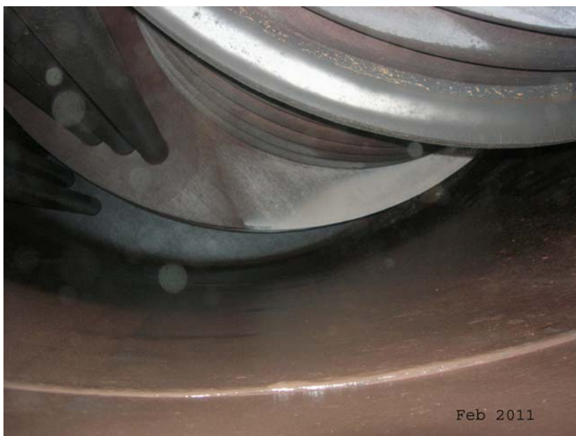
สภาพภายในหม้อไอน้ำหลังจากใช้สารเคมี Textreat430
